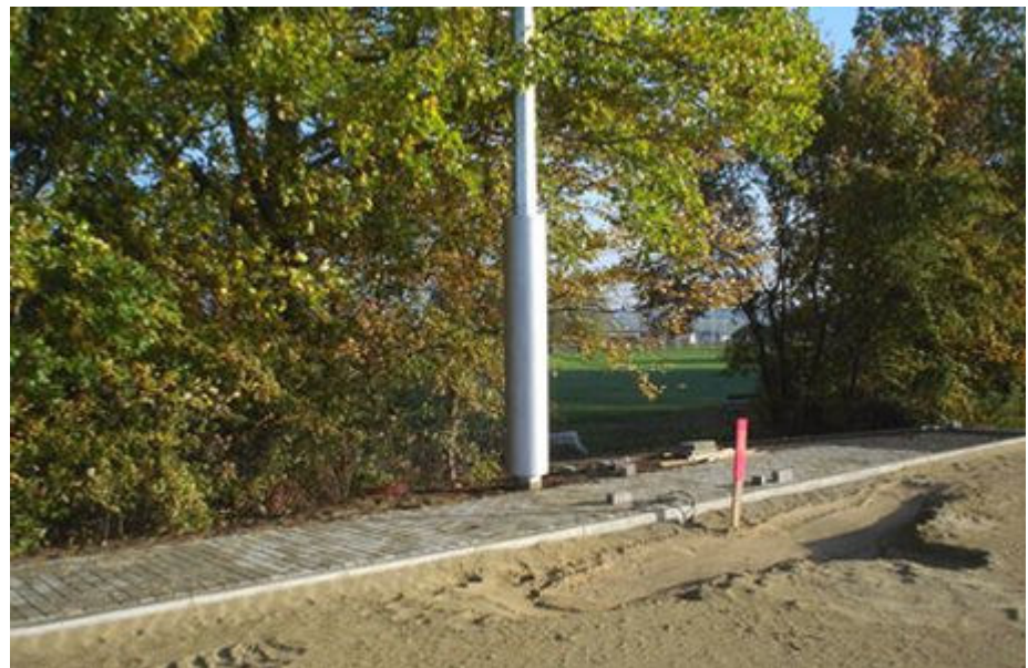
Flutlichtmast mit Berührungsspannungsschutz (äußerer Blitzschutz).
