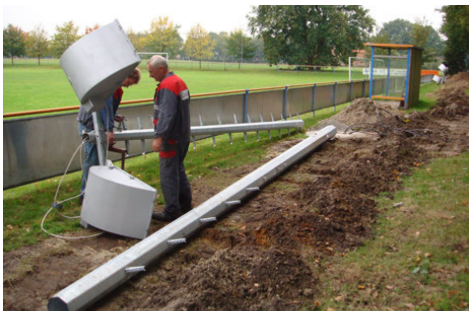
Die eingesetzten Leuchten sind gebraucht, Masten, Elektroeinrichtungen und Leuchtmittel dagegen neu.
