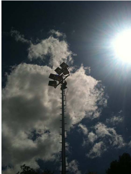
Sechs Scheinwerfer auf zwei Ebenen sorgen künftig von sechs Masten für die Ausleuchtung
