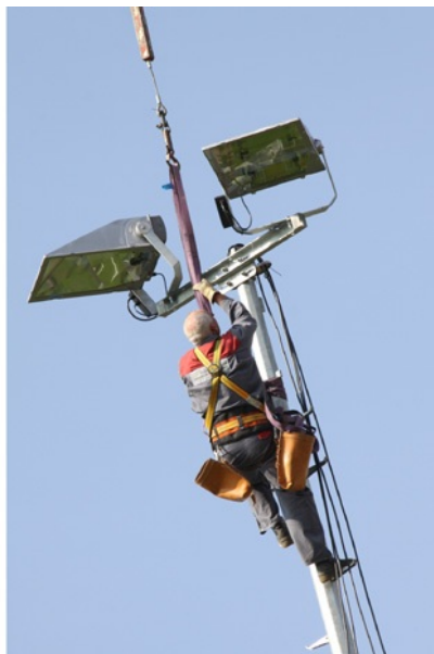
Es wurden Scheinwerfer vom Typ Siteco SiCompact A2 Maxi installiert
